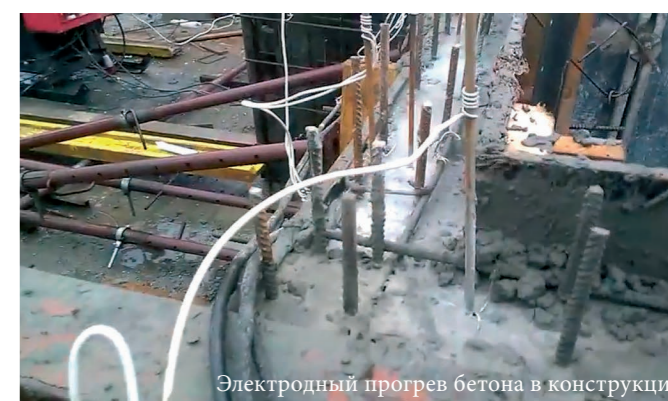
Расходный бункер, оснащённый электродами для предварительного разогрева бетонной смеси
